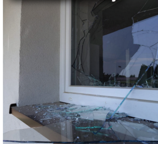
Chuligański wybryk: wybite okno, zniszczona elewacja
